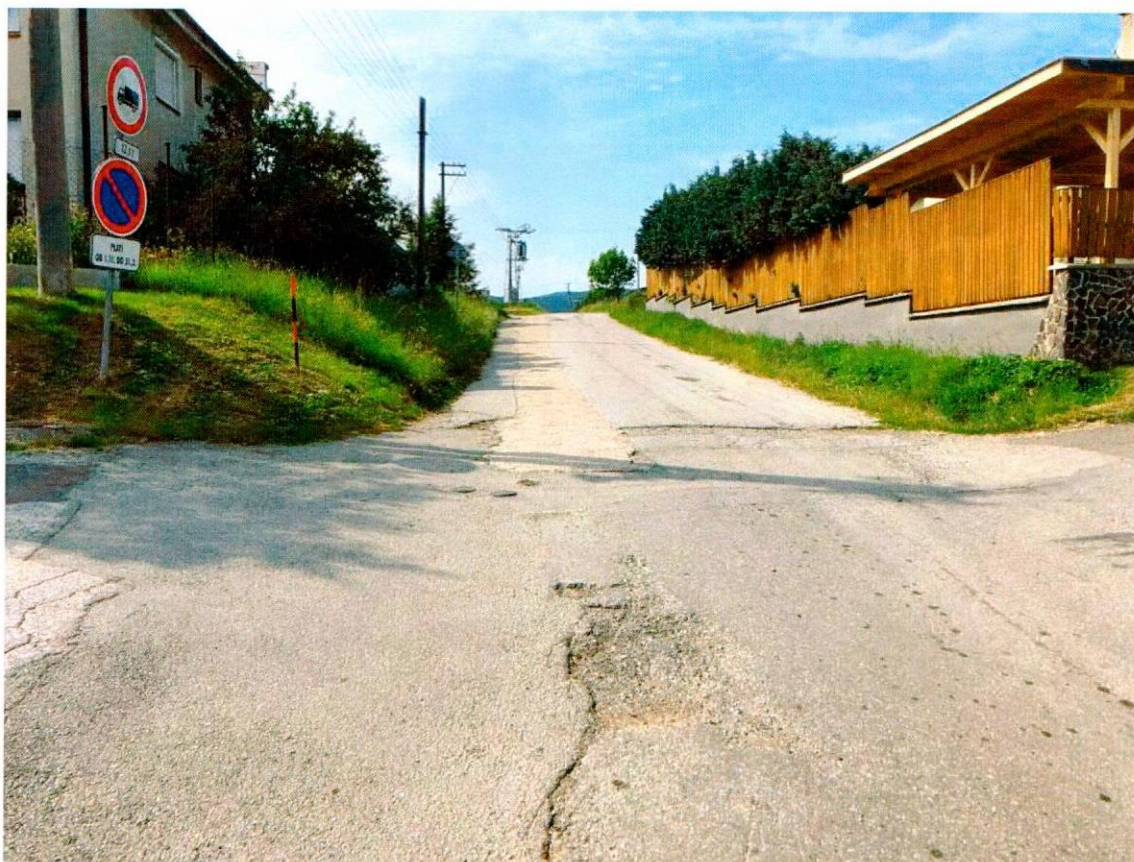
Obrázok č.2 – výtlky, sieťové rozpady, lokálny pokles nivelety vozovky
